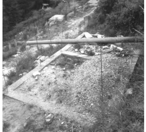
Die dünnen Armiereseisen der staatlich geplanten Häuser sind kaum zu erkennen
